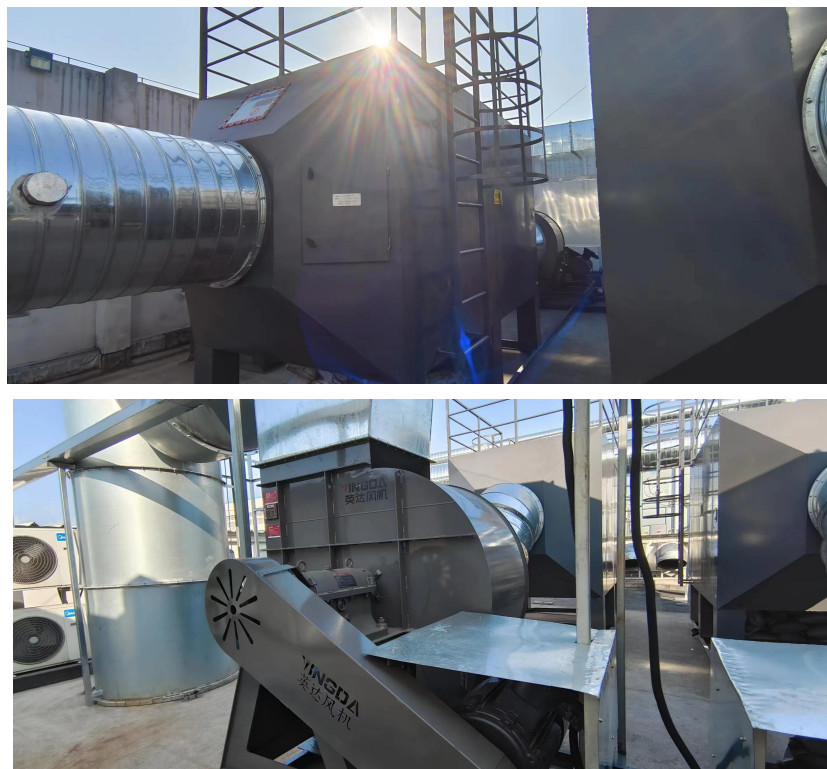
图 3-4 现状二级活性炭吸附装置照片
