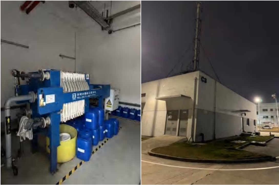
图4-3 废水站图片（左：污泥压滤机、右：废水站外观图）
