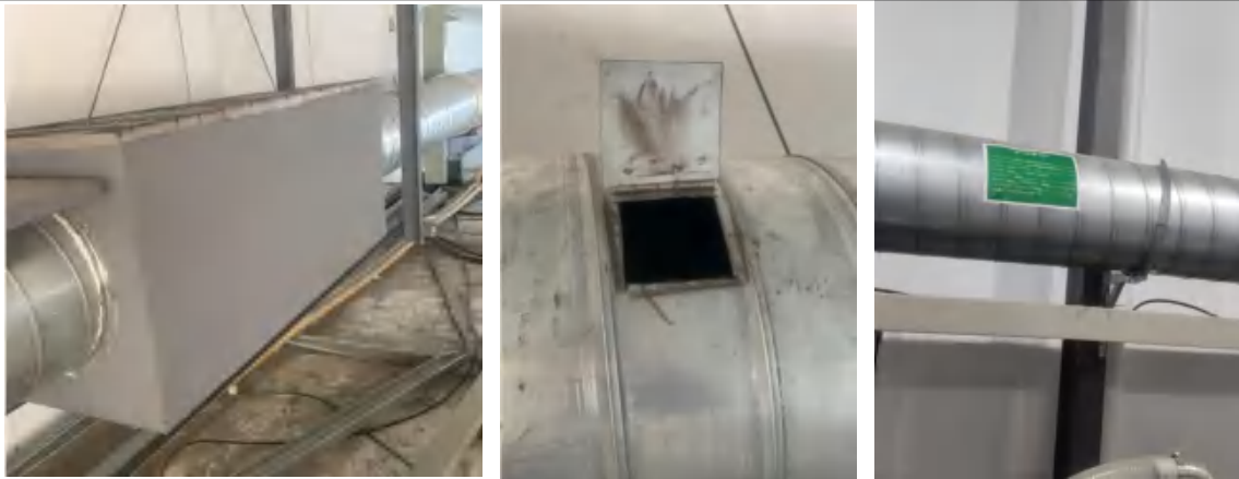
图3-2 废气处理设施、采样口及废气标牌照片
