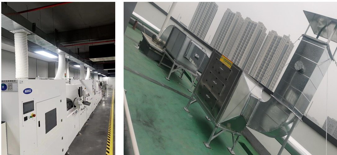
图 3-1 现状废气收集及活性炭吸附处理装置照片
