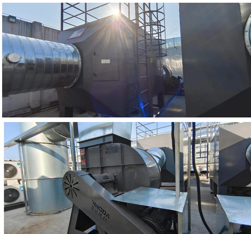
图 3-4 现状二级活性炭吸附装置照片
