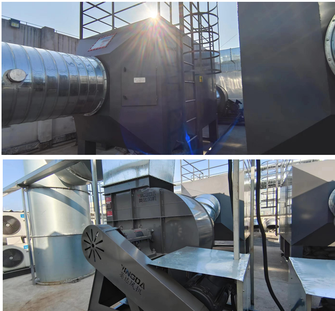
图 3-1 现状二级活性炭吸附装置照片
